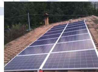
4,00 kWp - Morano Calabro
