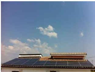
6,00 kWp - S. Lorenzo del Vallo
